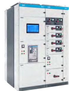
MLS LV Switchgear
