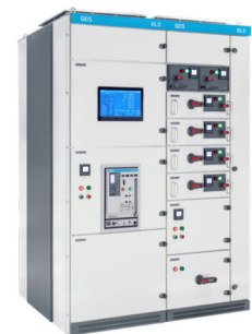
MLS LV Switchgear
